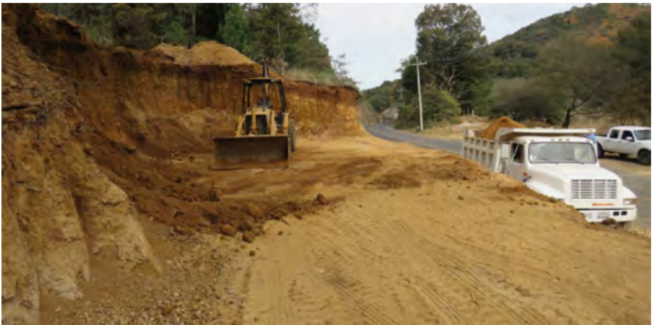
Clausura total y temporal de la Bocamina El Cristo, Xichú, Guanajuato. Fotografía: CONANP Región Centro y Eje Neovolcánico.
