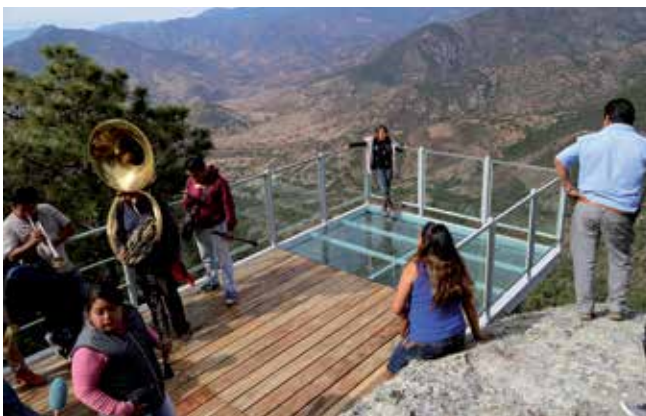
Construcción de un mirador en la región Yagul-Mitla, Oaxaca. Fotografía: Archivo CONANP.
